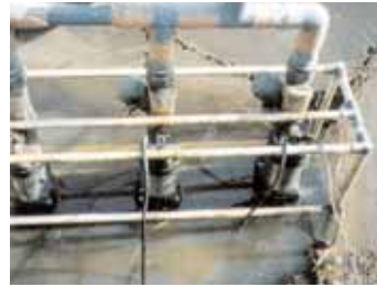
Wasserversorgung einer Krabbenzucht
